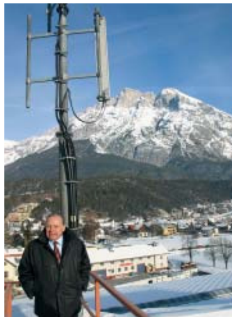
Auf dem Dach der Fa. Thöni stehen seit zehn Jahren insgesamt sieben Mobilfunkanlagen
